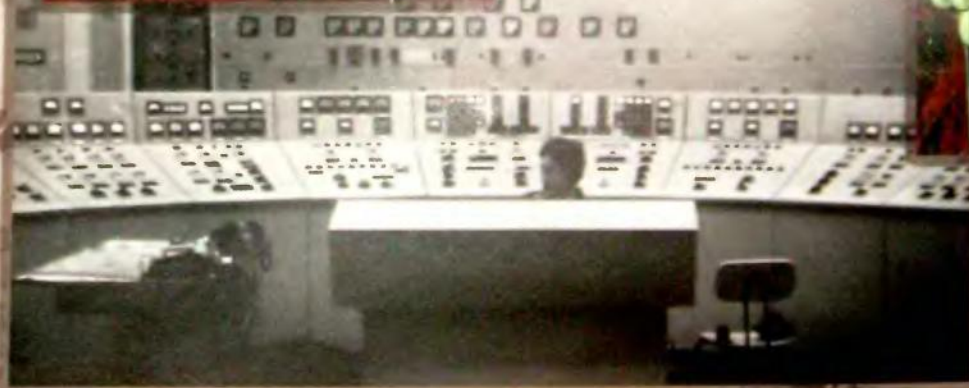
Пульт управления длинноволнового передатчика РВ-390.
